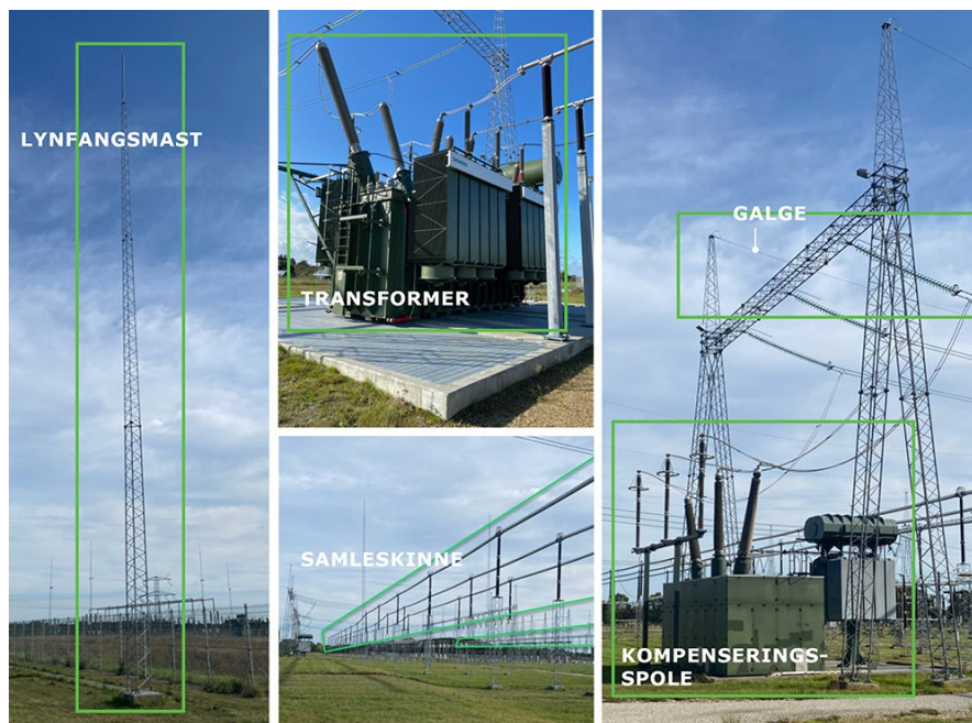
Figur 3-4 Illustration med eksempler på fritstående eltekniske anlæg såsom lynfangsmast, transformer, galge, samleskinne og kompenseringsspole. Kilde: Energinet.
