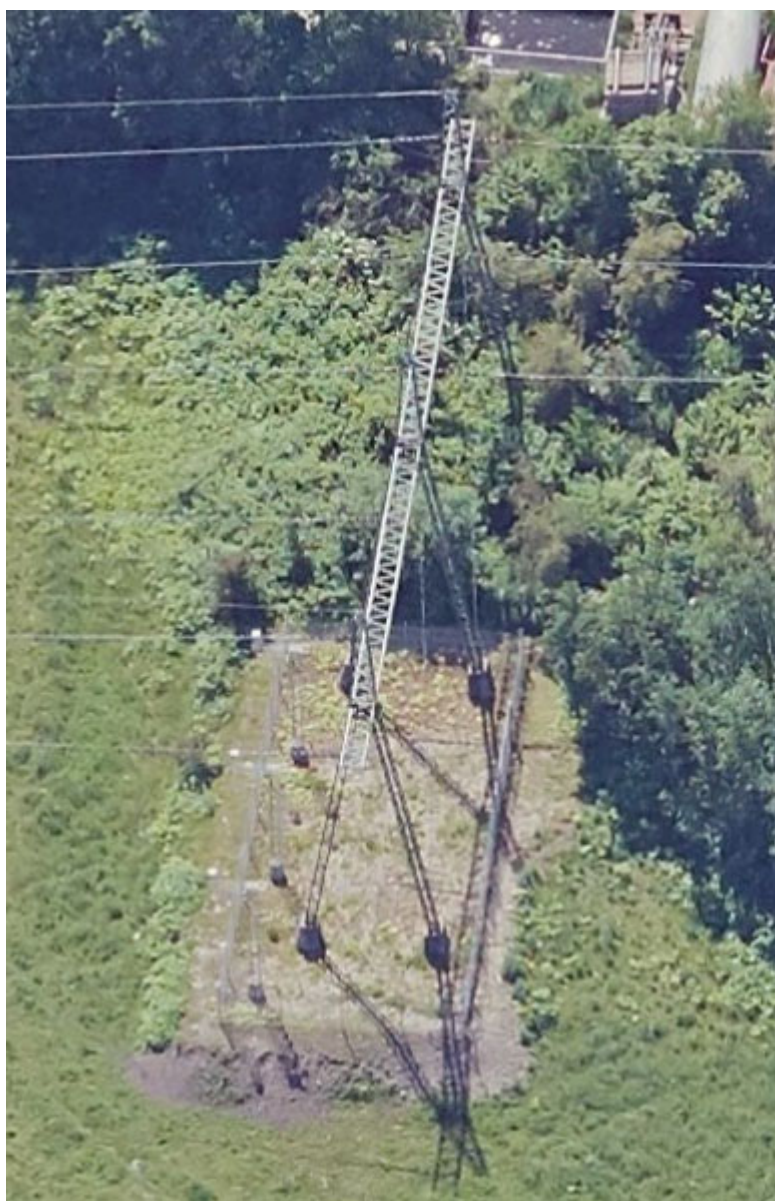
Figur 6–1 Stationsanlæg Lindved Å (LIÅ).
