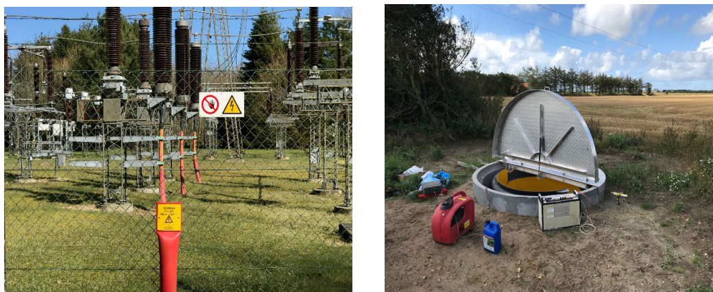
Figur 2–10 Eksempelfoto af markeringspæl og linkboksbrønd
