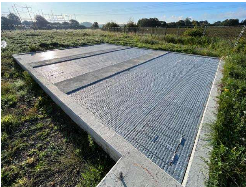
Figur 3.5. Fundament/kar som det ser ud inden transformer eller kompenseringspole placeres ovenpå.
