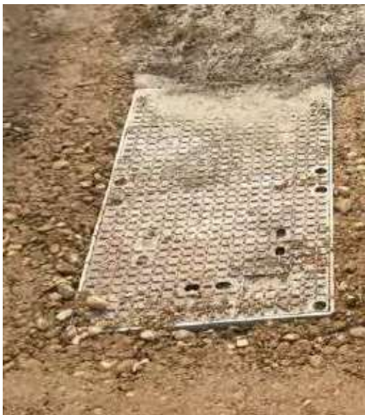
Figur 5.2. Eksempel på fiberbrønd i terræn
