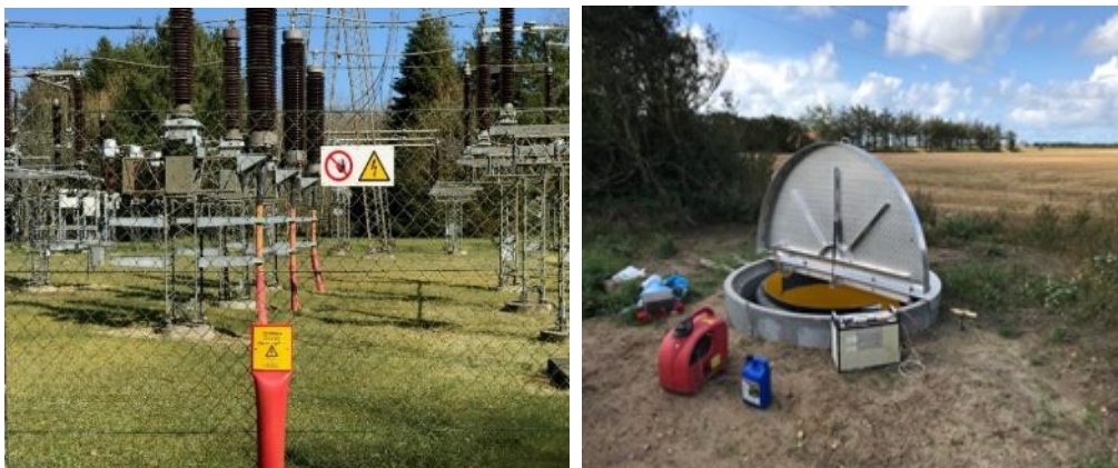
Figur 2-18 Eksempelfoto af markeringspæl og linkboksbrønd
