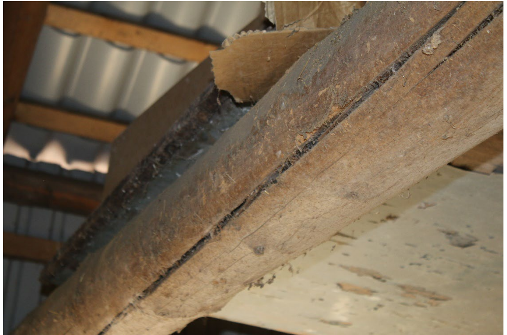
Figur 5-24 Flere af tagspærene har dybe sprækker, der ikke kan udelukkes at være dybe nok til at fungere som skjul for flagermus. Sprækkerne er dog fyldt med spindelvæv, der antyder, at dette ikke aktuelt er tilfældet.
