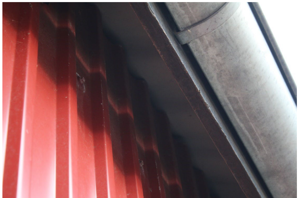
Figur 5-17 Ud mod gårdspladsen vurderes murværk at slutte tæt mod tagudhæng.
