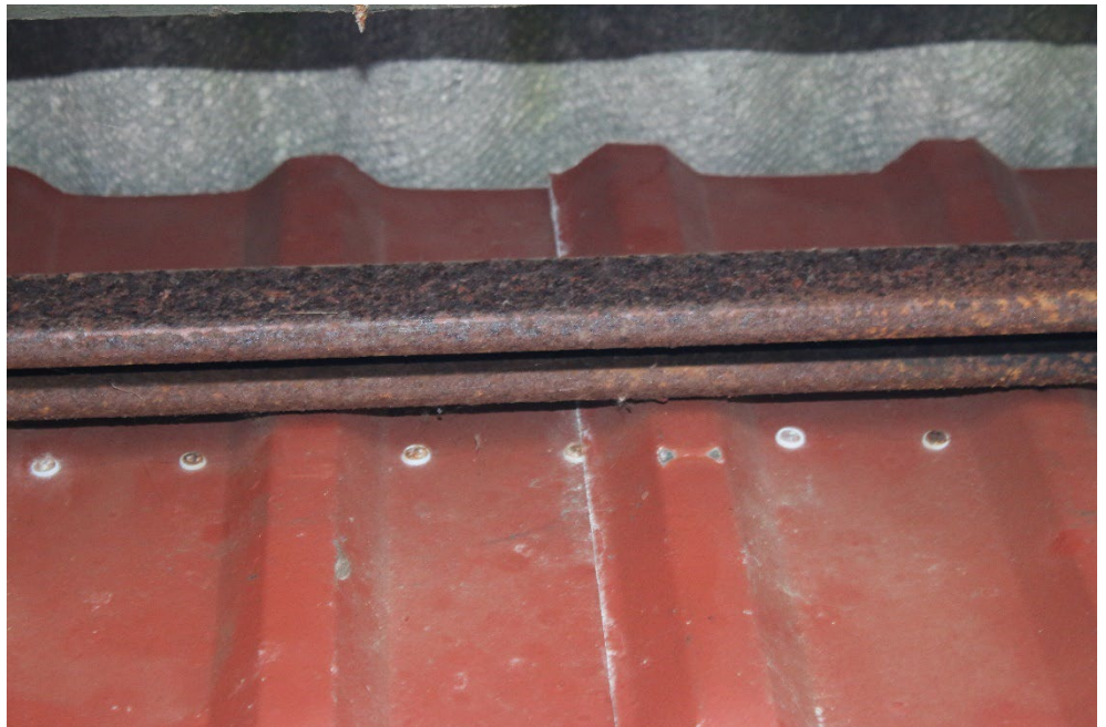
Figur 5-10 Vægge slutter ikke tæt til tagplader og giver dermed adgang til bygningens indre.
