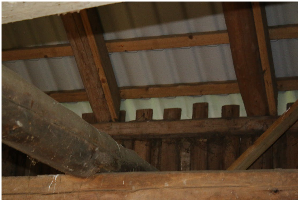
Figur 5-22 Murværk ud mod haven slutter ikke tæt til tagudhæng.
