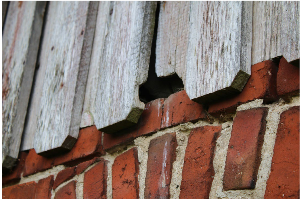
Figur 5-20 Brædder over murværk ud mod haven har flere steder huller/sprækker, der giver adgang til bygningens indre og synes at bære præg af slid.
