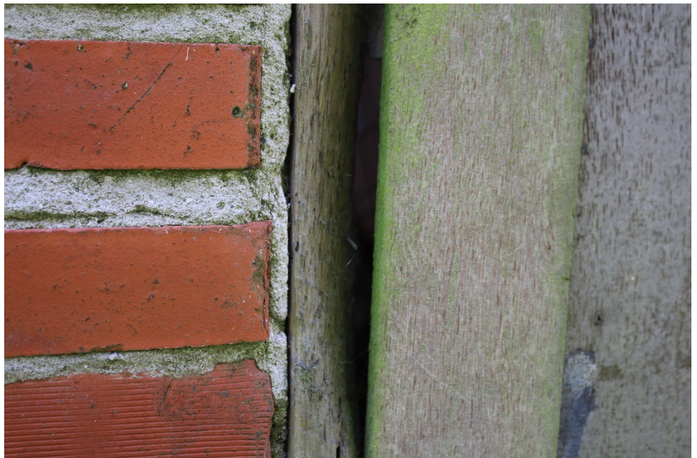
Figur 5-21 Ved aflukket vindue mod nord synes sprække med aflukning og vindueskarm at bære præg af slid, der ikke kan udelukke at stamme fra dyr.
