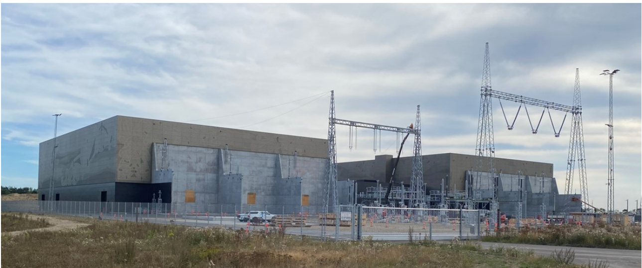
Figur 9.15. Eksempel på et bipol konverteranlæg under opførelse. Viking Link – Revsing. Der forventes opført lignende bygninger i både Solhøj og på Bornholm. Højde: 25 meter.
