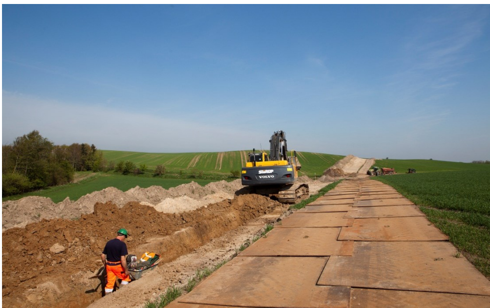
Figur 4.32. Eksempel på arbejdsbælte med afgrømet rå- og muldjord samt køreplader. Bemærk, at dette er et anlæg med et kabelsystem.
