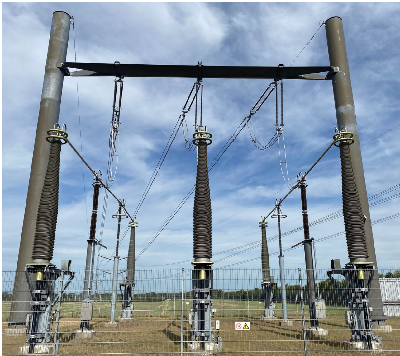
Figur 9.10. Eksempel på en overgangsmast (Overgangsportal) inklusive overspændingsafledere. Fra luftledning til kabel. Gamst. Højde: 25 meter. Fodaftryk: 23 x 20 meter.
