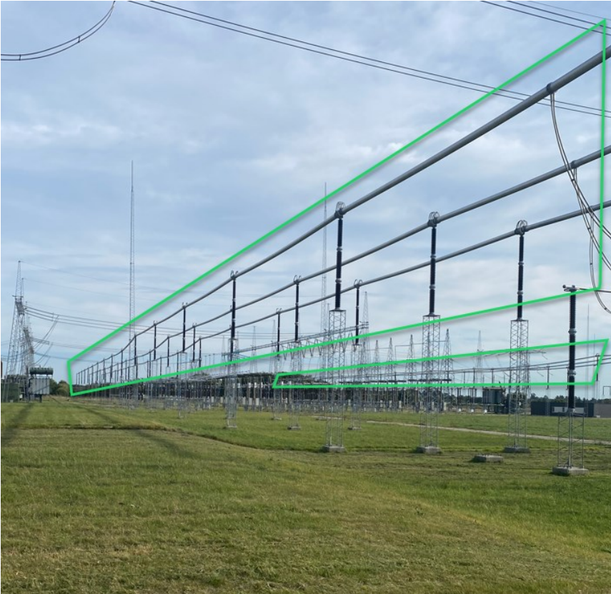
Figur 9.22. Eksempel på en 400 kV AC rørsamleskinne. Endrup. Højde: 12 meter. Fodaftryk: 10 x 300 meter.
