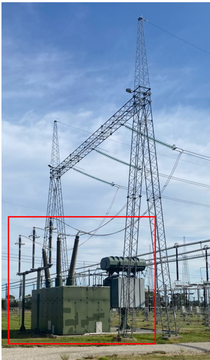
Figur 9.8. Eksempel på en kompenseringspole (Reaktor). ZL1 – Endrup. Højde ved gennemføringer: 10 meter. Fodaftryk kompenseringspole 12 x 13 meter. Fodaftryk fundament: 12 x 14 meter.
