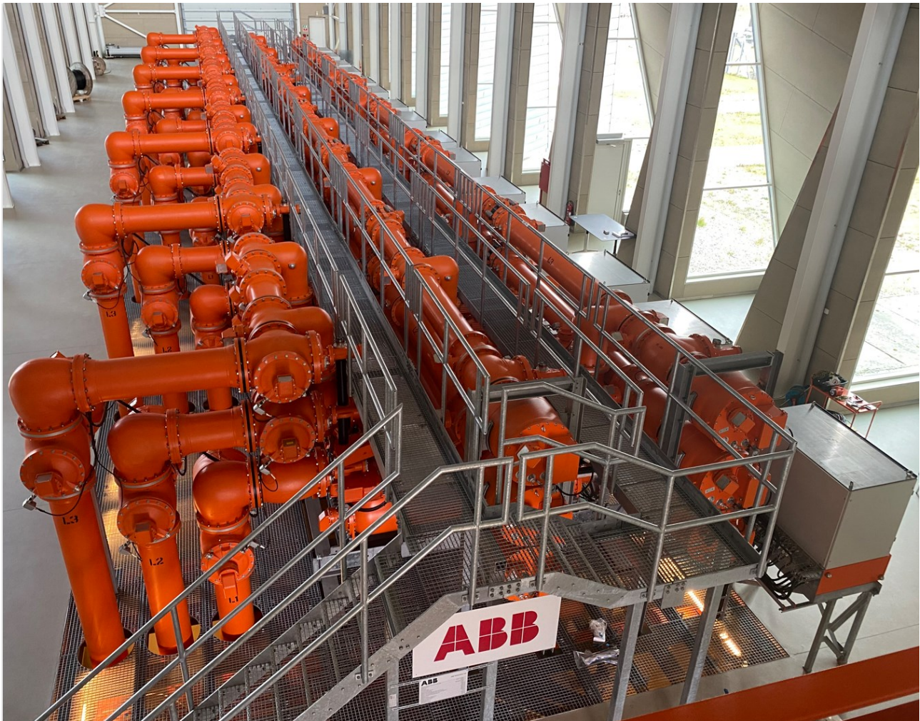
Figur 9.4. Eksempel på et 400 kV AC GIS anlæg indkapslet i en bygning som vist på Figur 9.1. Dobbelt samleskinne med dobbelt afbrydersystem. Syv felter og en langs adskiller. Revsing.
