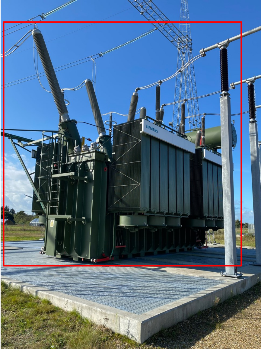
Figur 9.5. Eksempel på en transformer. KT52 – Idomlund. Højde ved transformergennemføringer: 11 meter. Fodaftryk transformer 10 x 15 meter. Fodaftryk fundament: 17 x 17 meter.
