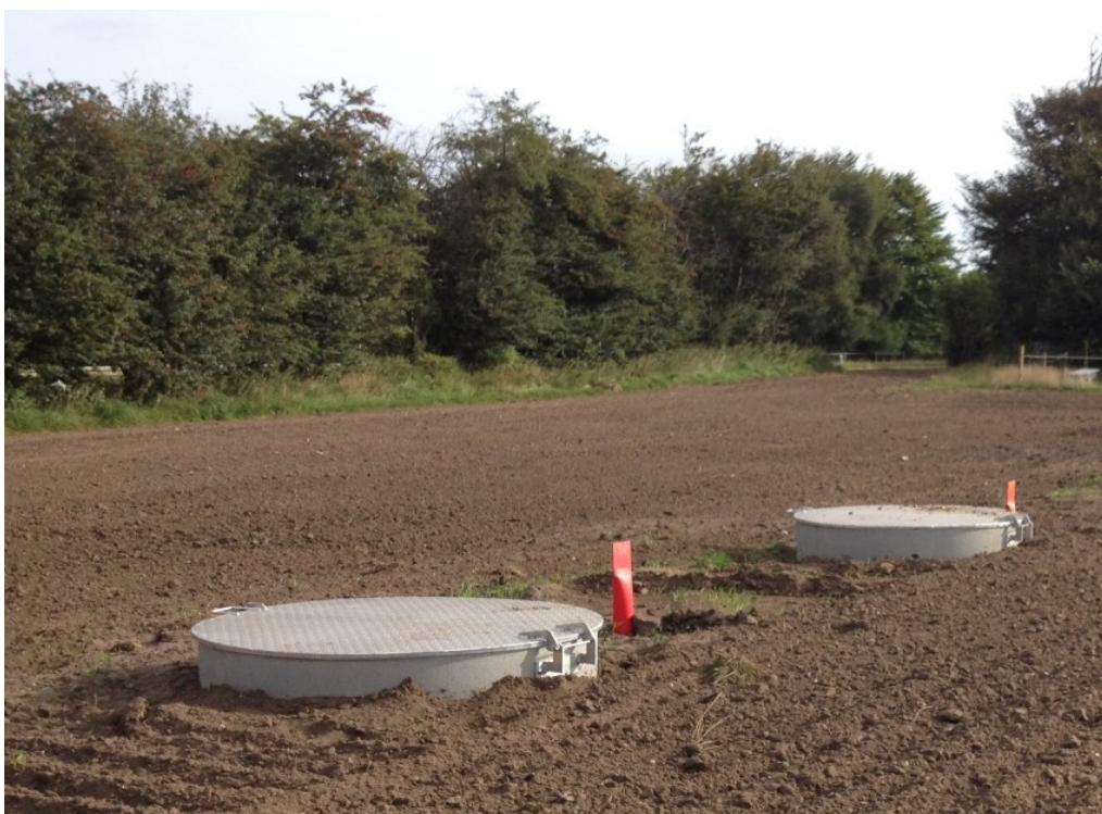
Figur 4.28. Eksempelfoto af linkboksbrønd i terræn.
