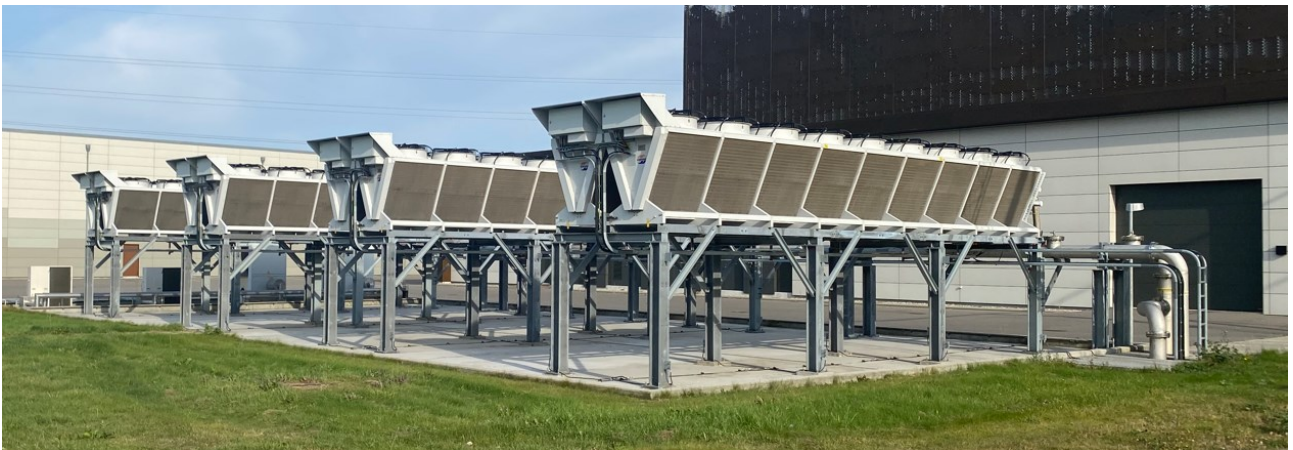
Figur 9.20. Eksempel på køleanlæg foran konverterbygninger. Cobra – Endrup. Højde: 4 meter. Fodaftryk: 15 x 35 meter.
