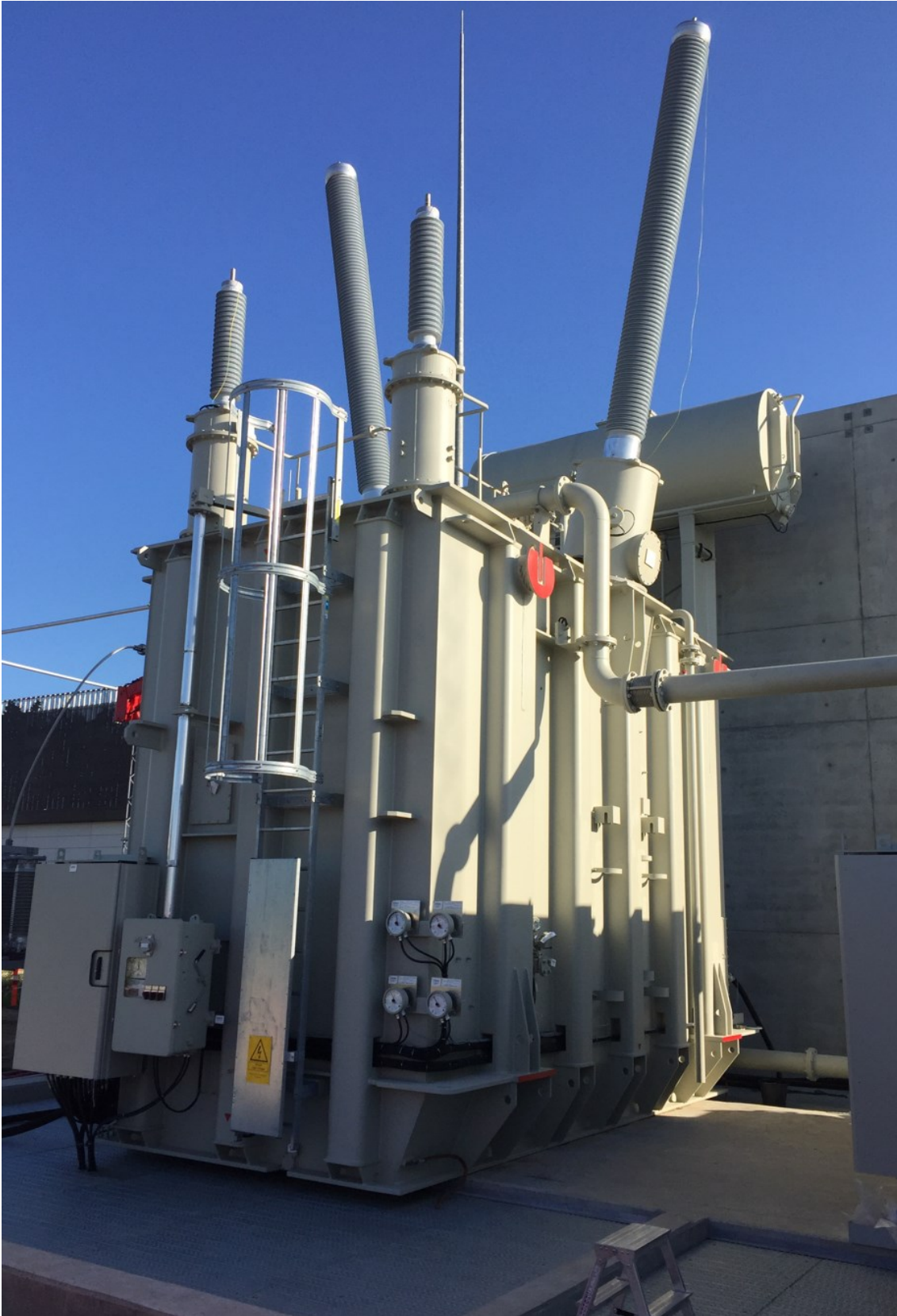
Figur 9.18. Eksempel på en konvertertransformer. Cobra – Endrup. Højde ved transformergennemføringer: 15 meter.
