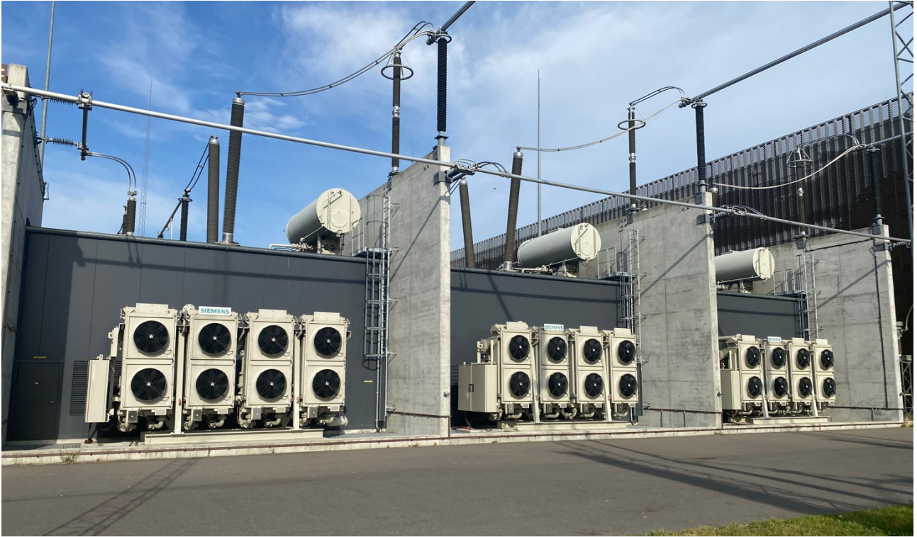
Figur 9.19. Eksempel på konvertertransformerne ved Cobra i Endrup. Totalt fodaftryk: 45 x 12 meter.
