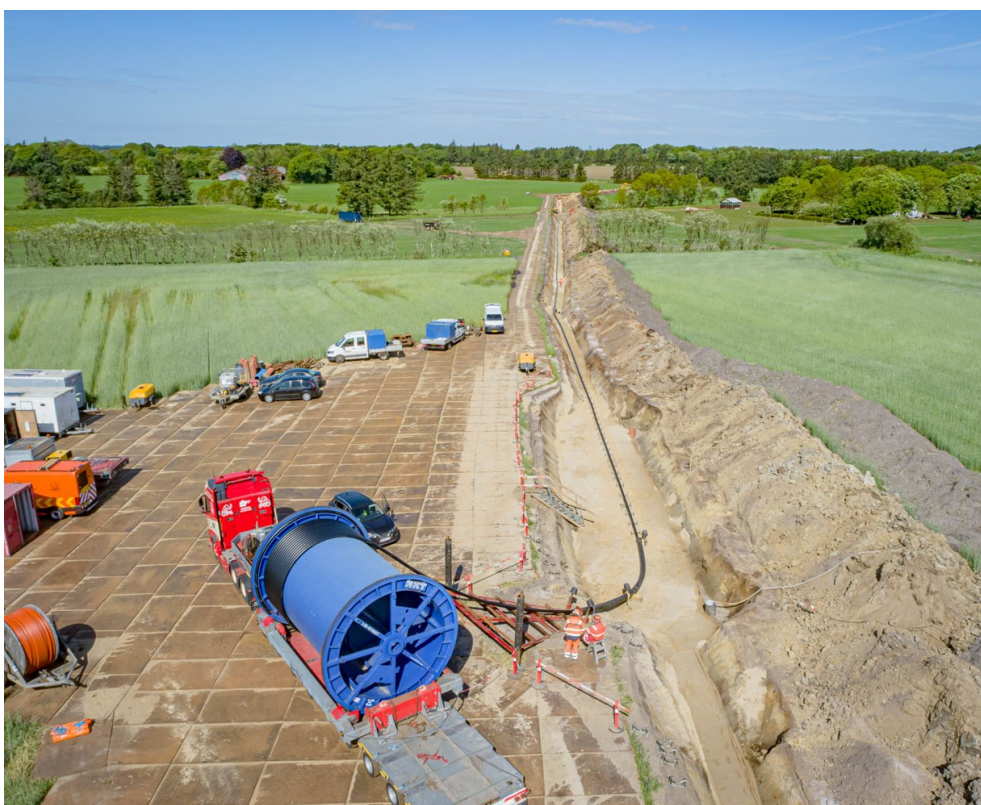
Figur 4.34. Eksempel på en kabelrende lige efter udtrækning af kabler. Oplagsplads ses til venstre i billedet.
