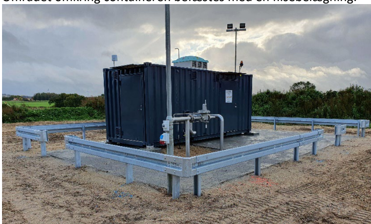
Figur 9 - Foto som viser eksempel på en BMR-station
