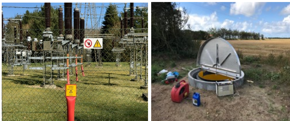
Figur 2-15 Eksempelfoto af markeringspæl og linkboksbrønd
