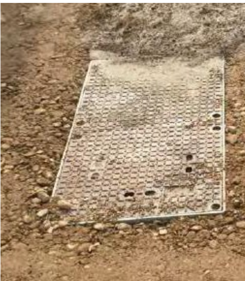
Figur 2-3 Eksempel på fiberbrønd i terræn
