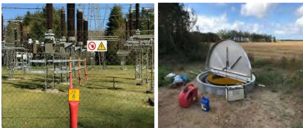
Figur 2-20 Eksempelfoto af markeringspæl og linkboksbrønd
