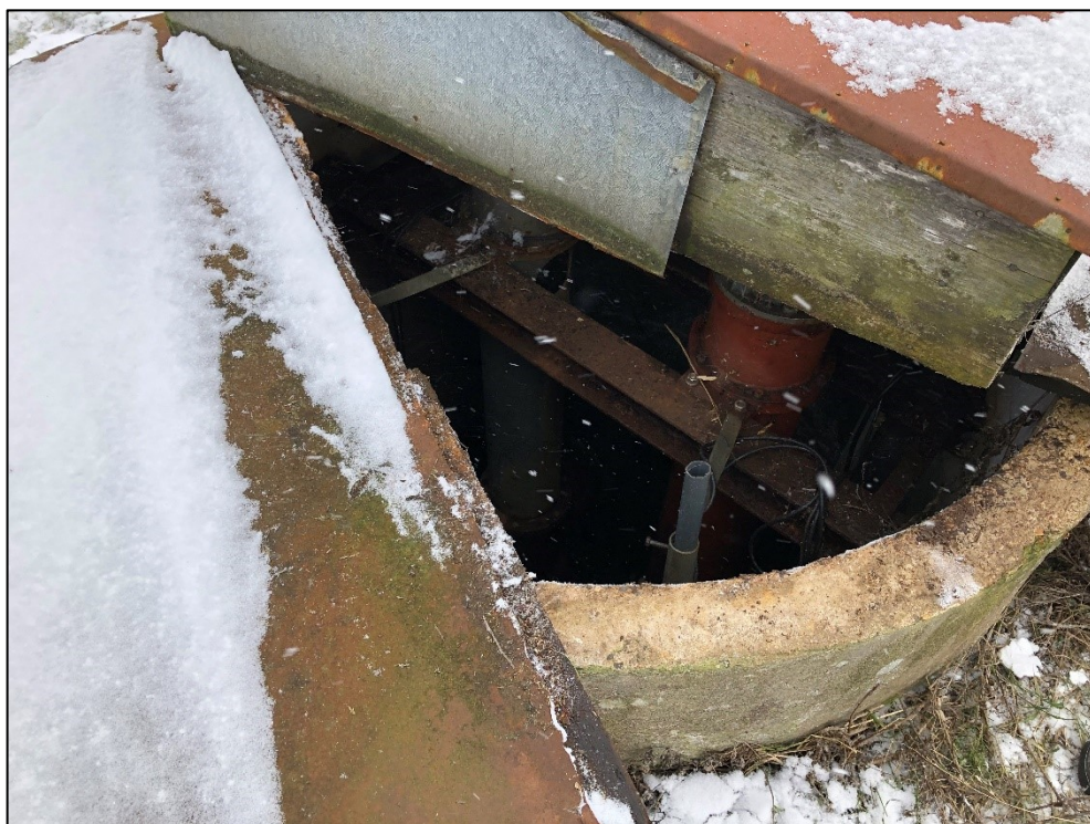
Figur 3-1. Billede af pumpebrønden ved pumpestationen.
