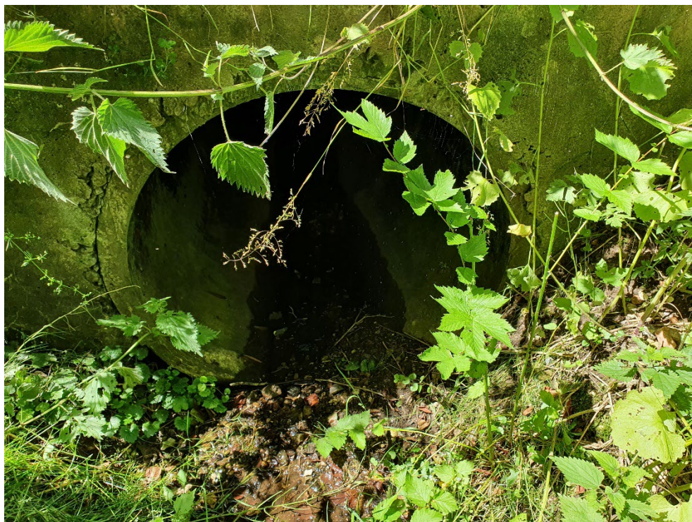
Figur 4: Ø900 mm rør under jernbanen i forbindelse med banegrøften
