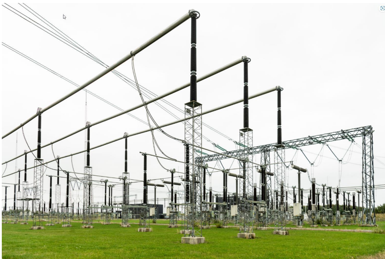
Figur 4 Fotografi af sammenlignelig AIS-station
