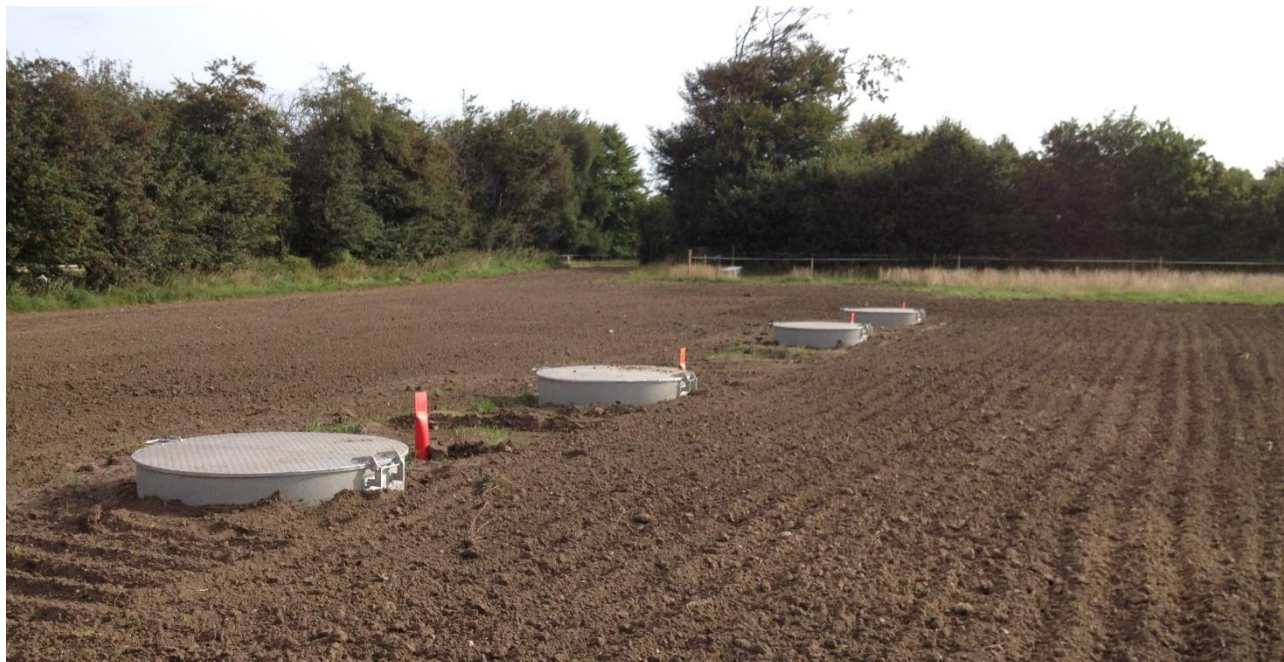
Foto 4-1 Eksempel på teknikbrønde ved fire parallelle kabelsystemer. Ved siden af teknikbrøndene står røde markeringsstandere. Placering og behov for markering vil være en konkret vurdering i de enkelte tilfælde. Der er en brønd for hvert kabelsystem.
