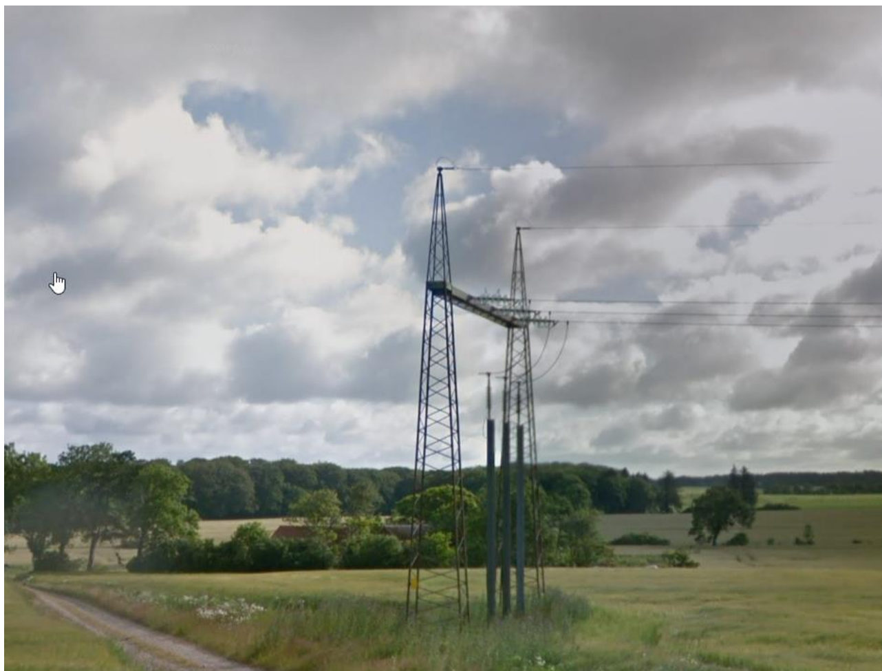
Figur 10-10 Kabeovergang og endetræksmast
