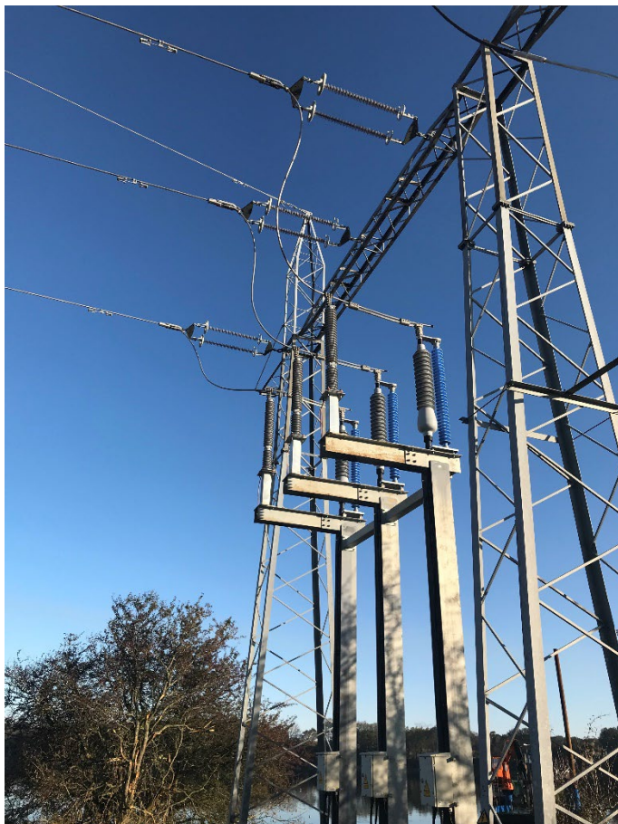
Figur 6–2 Eksempelfoto af overgangsmast.
