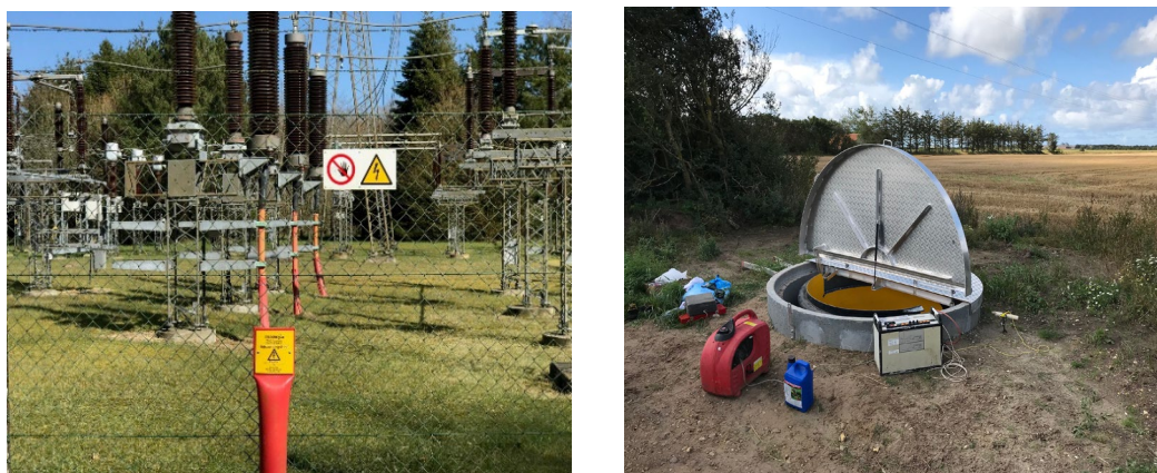
Figur 2–15 Eksempelfoto af markeringspæl og linkboksbrønd.
