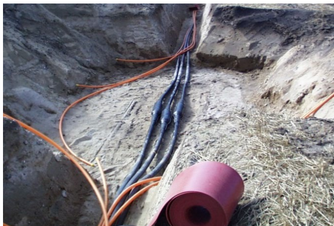
Figur 2-14 Kablerne er muffet sammen.
