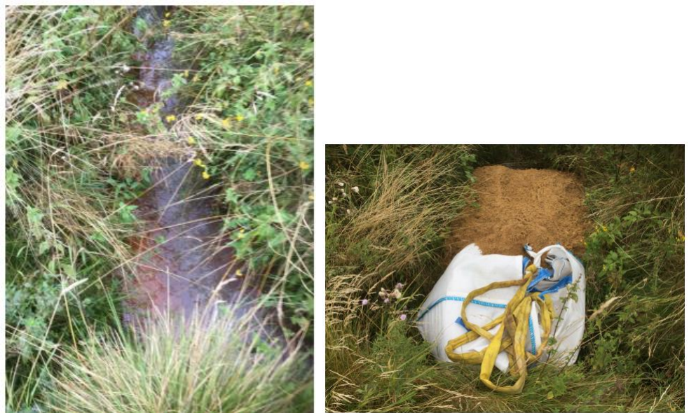
Figur 15-4 I forbindelse med Energinets projekt, Horns Rev 3, hvor et kabelanlæg blev nedgravet i 2015, skete der et blow-out ved en bæk. Her blev der anvendt bigbags med sand til inddæmning.
