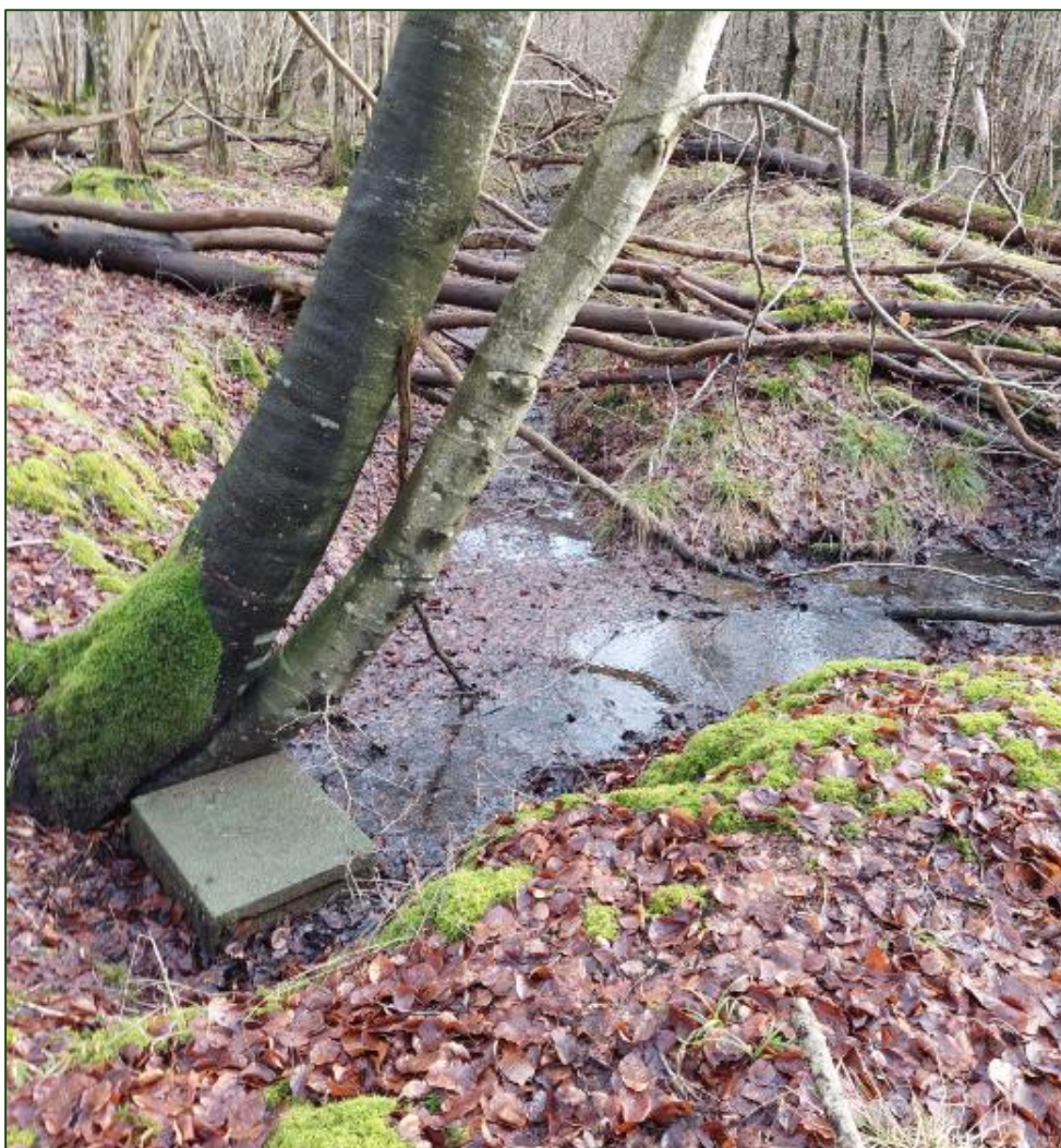
3.2.12 Figur 3.24 H11, hvor de to grøfter opstrøms kisten til den rørlagte vandløbsstrækning mødes. Opstrøms kisten tilkastes på samlet ca. 110 meter grøft.
