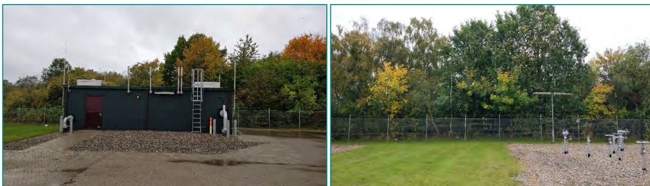
Figur 1-8: Eksempel på M/R-station til venstre og linjeventil-station (L/V-station) til højre.
