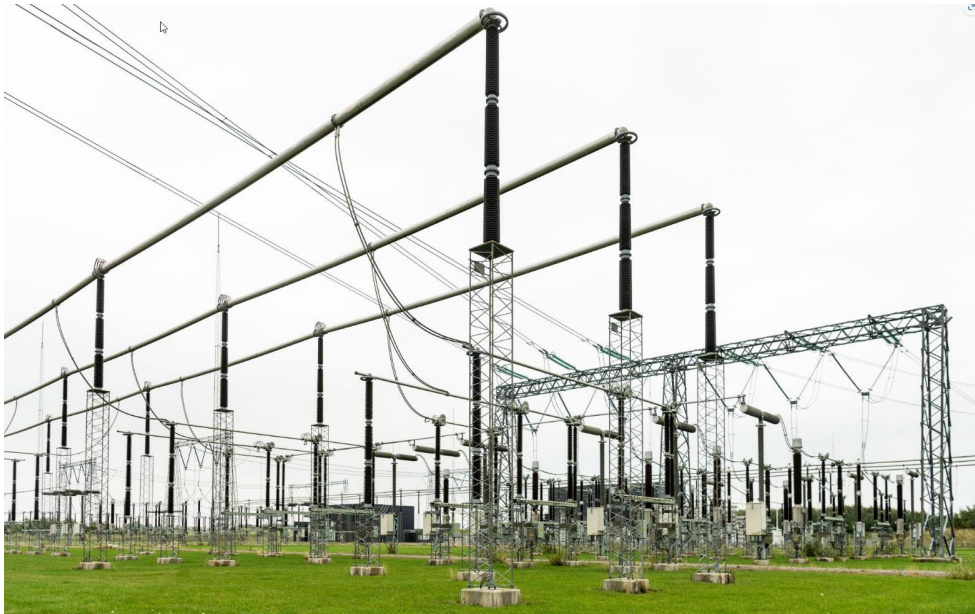
Figur 4 Fotografi af sammenlignelig AIS-station
