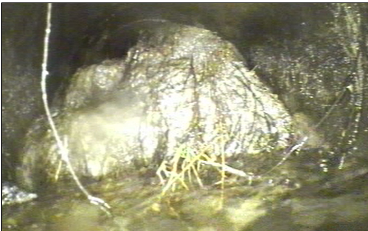
Foto 2 - Trærødder i drænrøret, udklip fra tv-inspektionsvideo.
