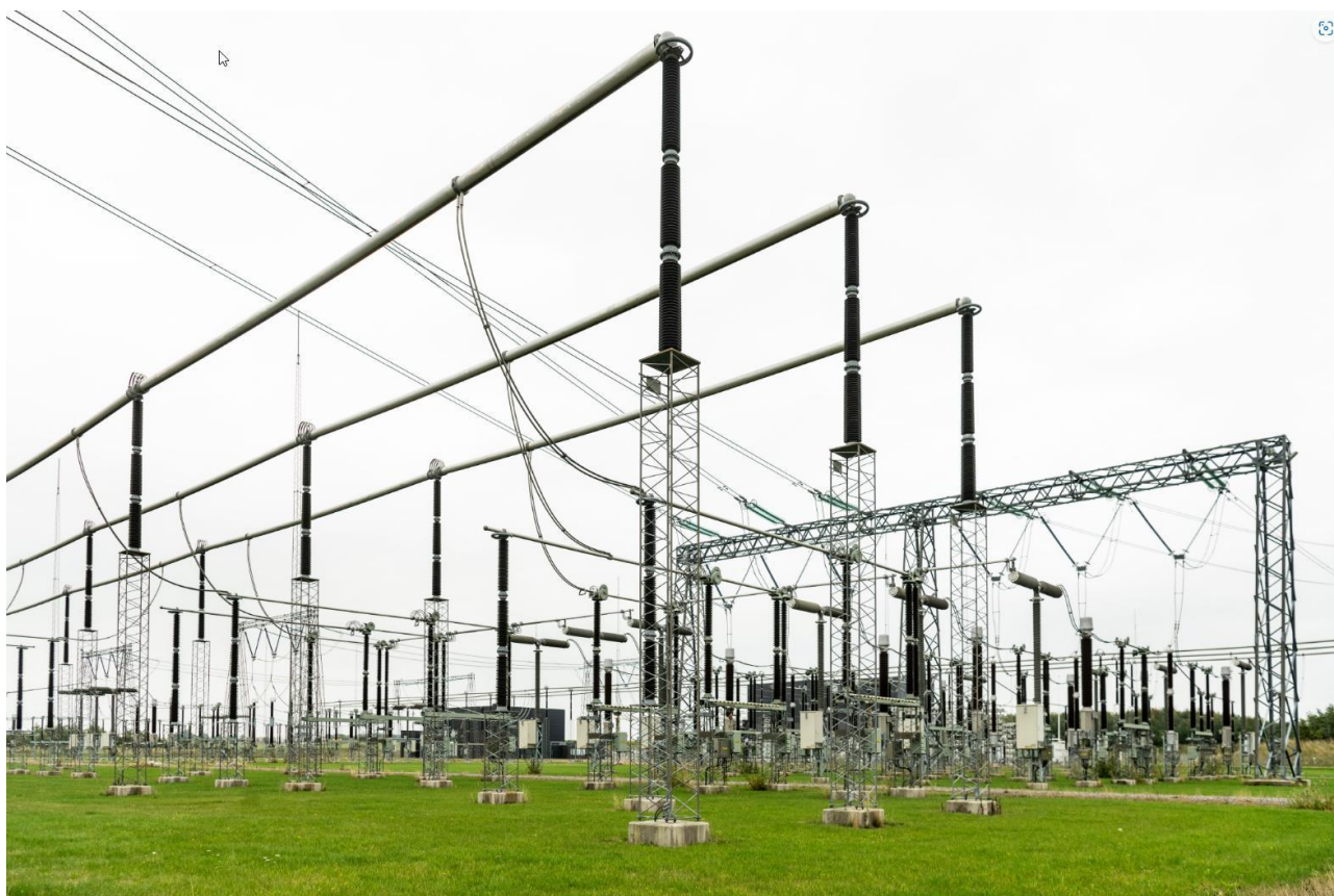
Figur 4 Fotografi af sammenlignelig AIS-station
