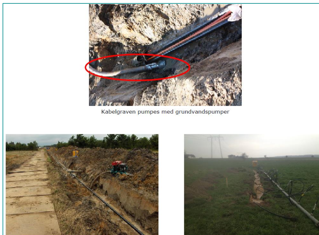
Figur 8 Forskellige metoder til at holde kabelgraven tør. På billedet til venstre etableres drænrør, til højre etableres sugespidsanlæg.
