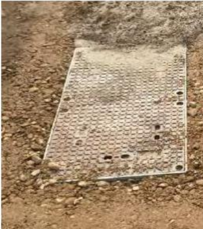
Figur 4 Eksempel på fiberbrønd i terræn.
