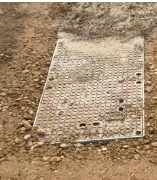
Figur 2-3 Eksempel på fiberbrønd i terræn
