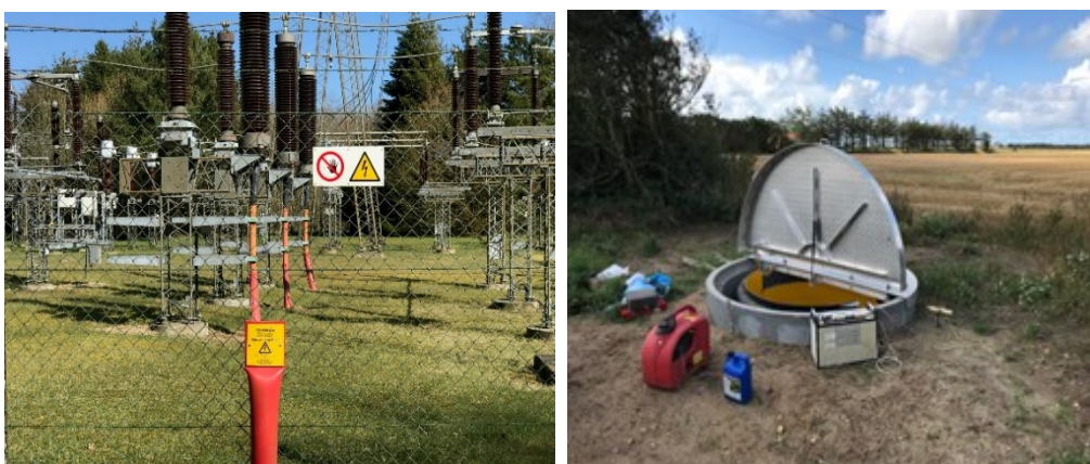
Figur 2-16 Eksempelfoto af markeringspæl og linkboksbrønd
