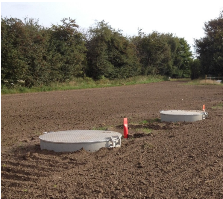
Figur 2-3: Eksempel – foto af linkboksbrønd i terræn.
