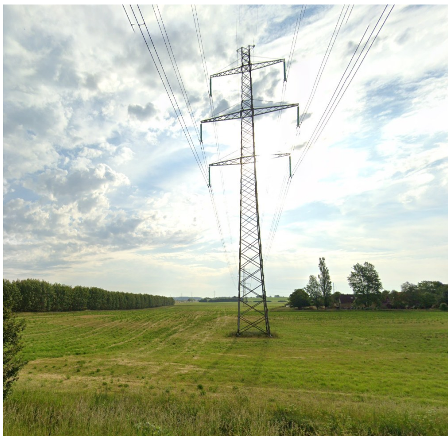
Figur 5-3: Foto fra terræn af ligeløbsmast med dobbelt luftledningssystem.
