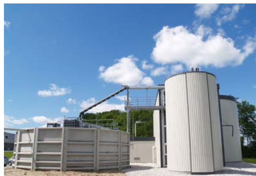
Tannergård Biogas, et gårdbiogasanlæg.
