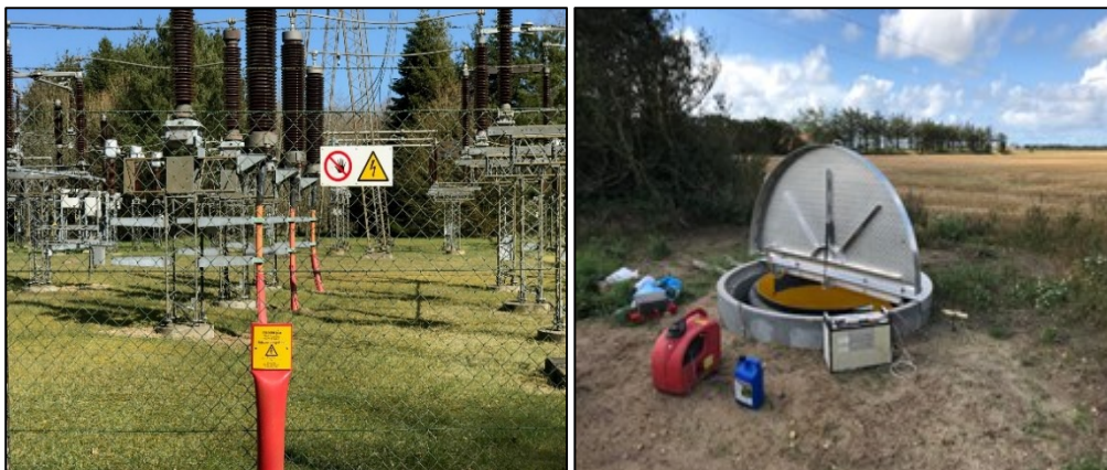
Figur 3-7. Eksempelfoto af markeringspæl og linkboksbrønd.
