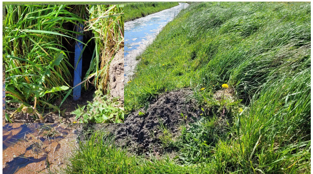
Figur 3-21 Der var to grave i vandløbsbredden med en højde i indgangshullet på ca. 30 cm (foto i øverste venstre hjørne).
