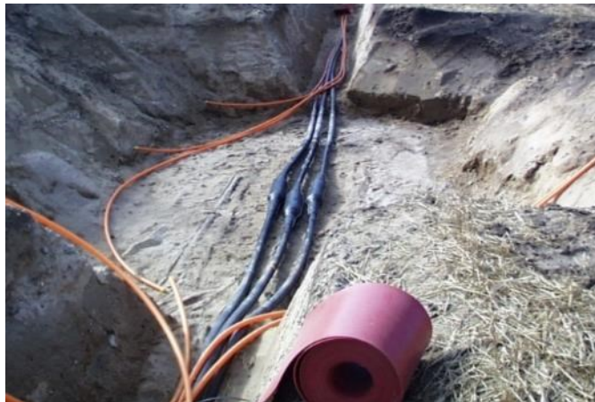
Figur 2-15 Kablerne er muffet sammen
