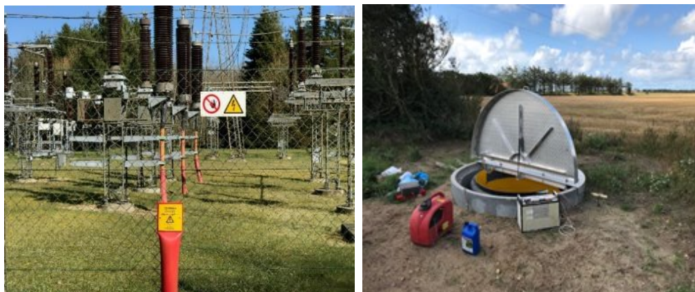
Figur 2-17 Eksempelfoto af markeringspæl og linkboksbrønd
