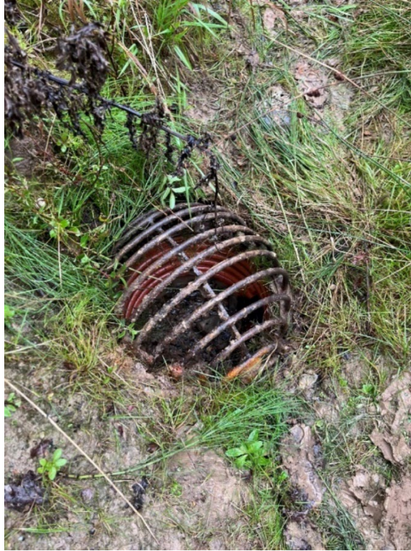
Figur 15. Eksisterende tilslutning fra grøft til rørlagt vandløb.
