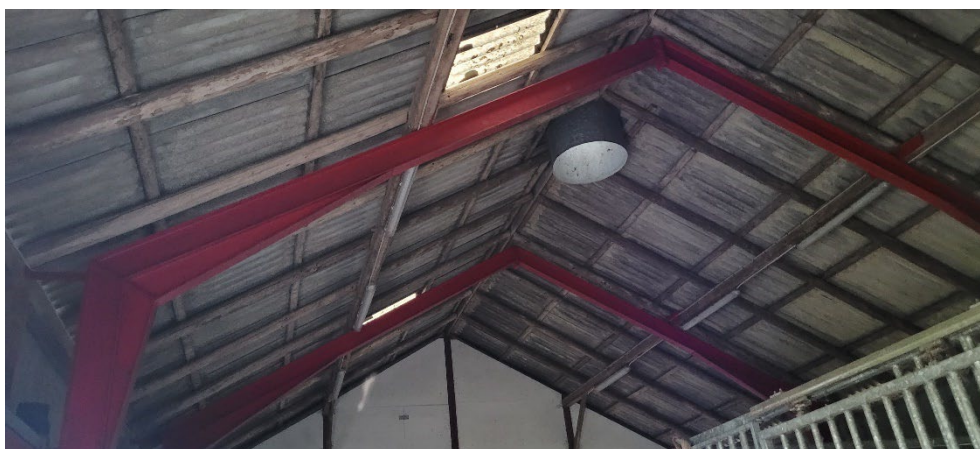
Figur 3-18 Tagkonstruktionen i hestestalden på Kassøvej 25. Brun langøre vil potentielt kunne finde rastesteder over spærene, og dværg- og pipistrelflagermus vil kun finde rast under rygningen, men der blev ikke fundet tegn på dette ved undersøgelserne.
