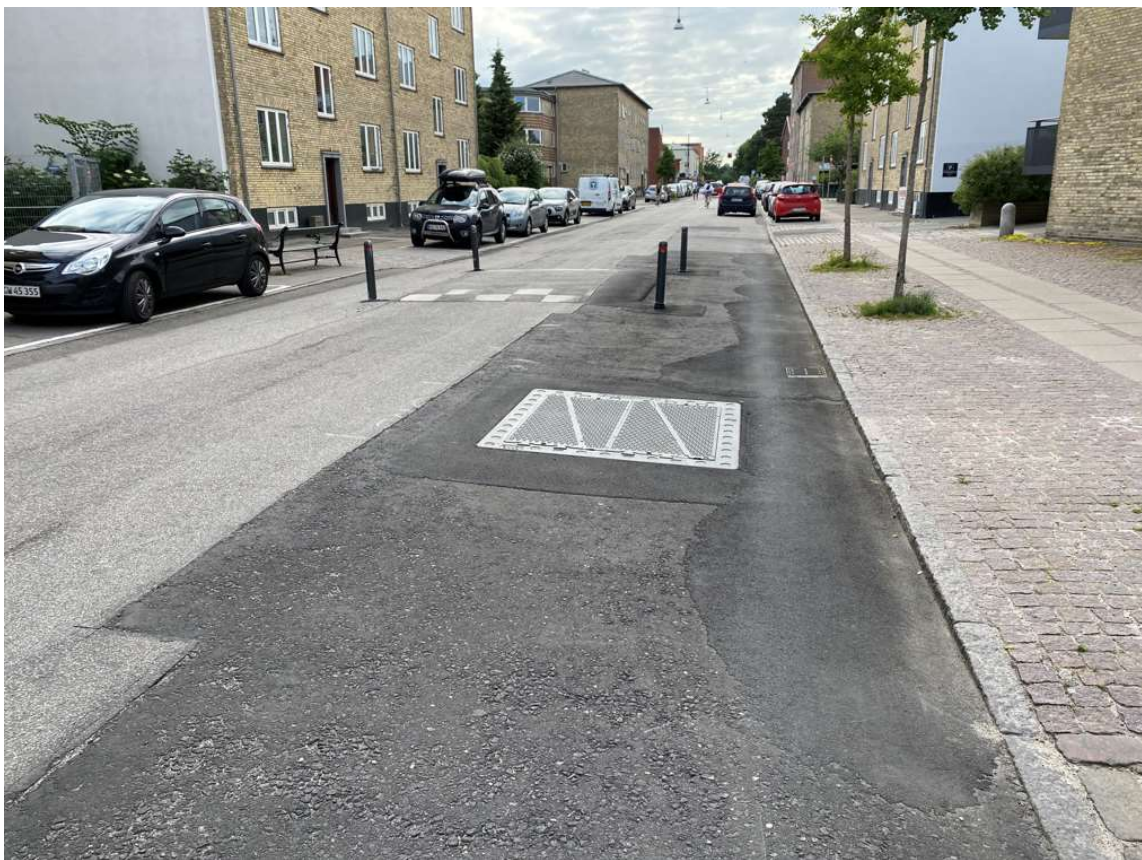
Figur 2-3: Linkboksbrønddæksel i vejareal.
