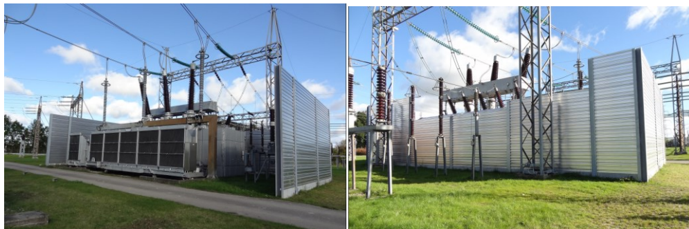
Figur 5-11 Eksempler på støjskærm på højspændingsstation
