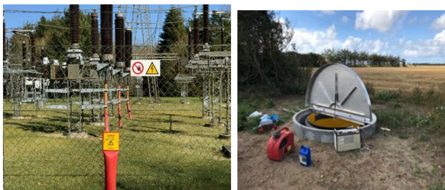
Figur 2-18 Eksempelfoto af markeringspæl og linkboksbrønd
