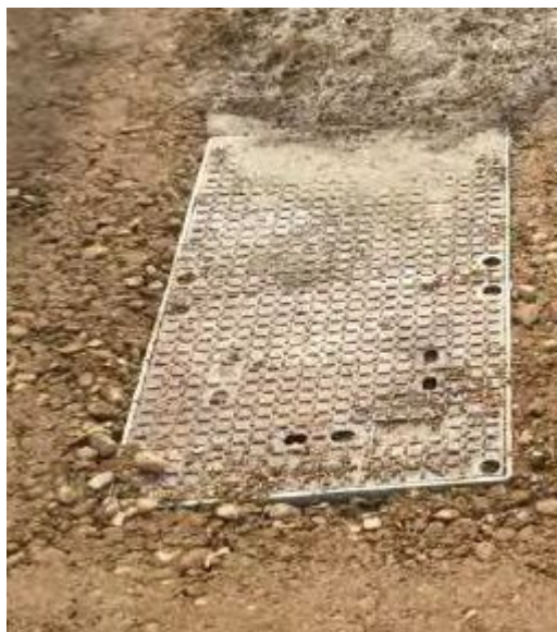
Figur 2-3 Eksempel på fiberbrønd i terræn
