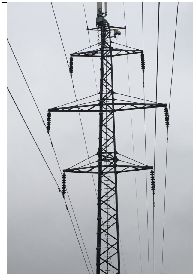
Figur 2-4: Eksisterende mast nr. 57 med isolatorkæder af porcelæn, der skal udskiftes.
