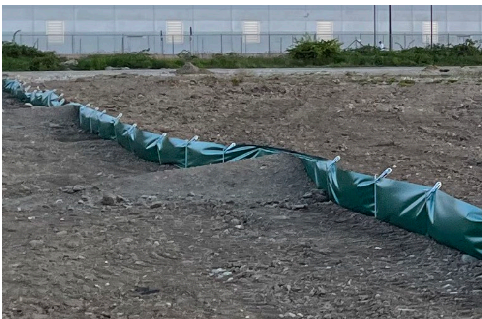
Figur 7-16 Jordrampe konstrueret med et "stativ" af træplader, hvor stativet ikke længere kan holde til jordens vægt, hvilket har resulteret i at rampen bliver fladere med tiden så det ikke længere flugter hegnets overkant.
