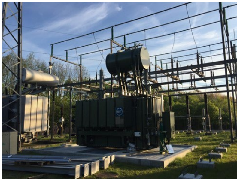
Figur 10-2 Eksempel på tekniske installationer placeret på støbte fundamenter.
