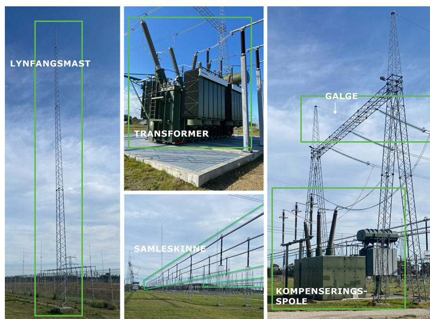
Figur 3-3 Illustration med eksempler på fritstående eltekniske anlæg såsom lynfangsmast, transformere, galge, samleskinne og kompenseringsspole. Kilde: Energinet.
