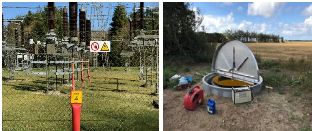
Figur 2-14. Eksempelfoto af markeringspæl og linkboksbrønd
