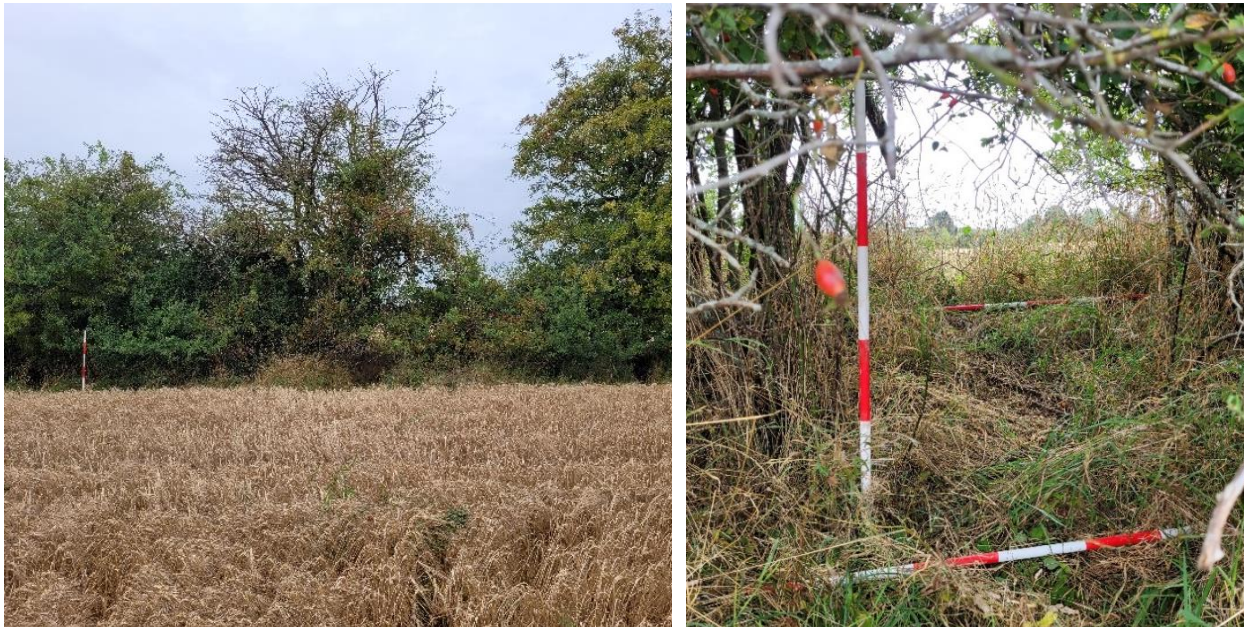
Figur 11 Fotos af det potentielle gennembrudssted. På fotoet til venstre ses diget med tilhørende hegn fra øst, og landmålerstængerne er placeret 10 m fra hinanden. Til højre ses et nærbillede af diget, hvor de vandrette landmålerstænger angiver toppen og foden af diget.
