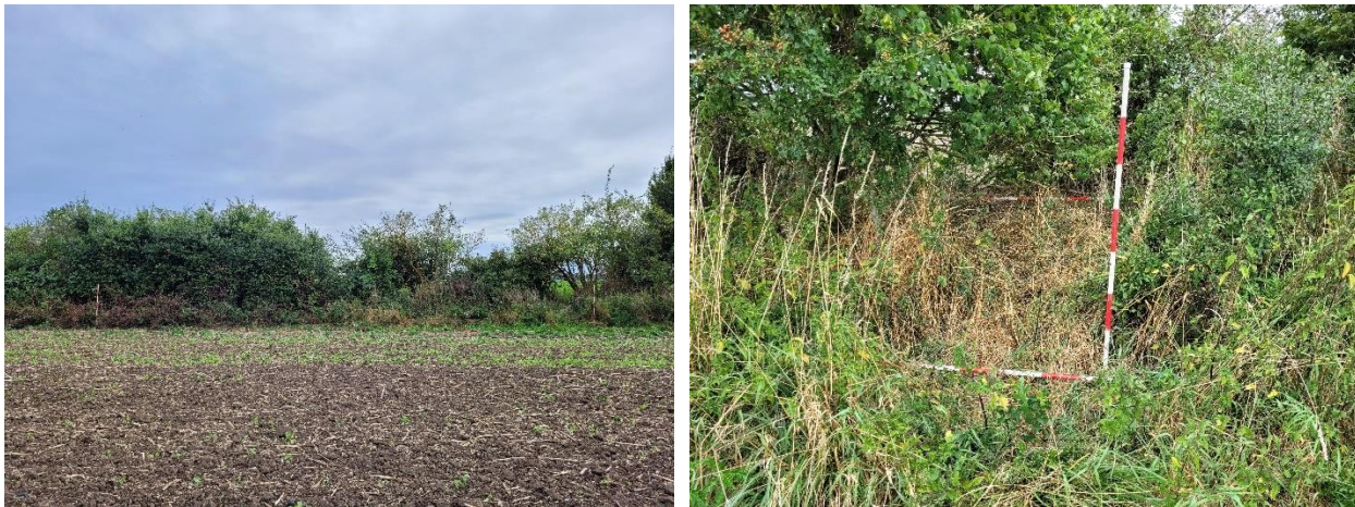
Figur 1 Fotos af det potentielle gennembrudssted. På fotoet til venstre ses diget med tilhørende hegn fra nord, og landmålerstængerne er placeret 16 m fra hinanden. Til højre ses et nærbillede af diget, hvor de vandrette landmålerstænger angiver toppen og foden af diget.
