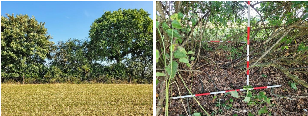
Figur 8 Fotos af det potentielle gennembrudssted. På fotoet til venstre ses diget med tilhørende hegn fra syd, og landmålerstængerne er placeret 16 m fra hinanden. Til højre ses et nærbillede af diget, hvor de vandrette landmålerstænger angiver toppen og foden af diget.
