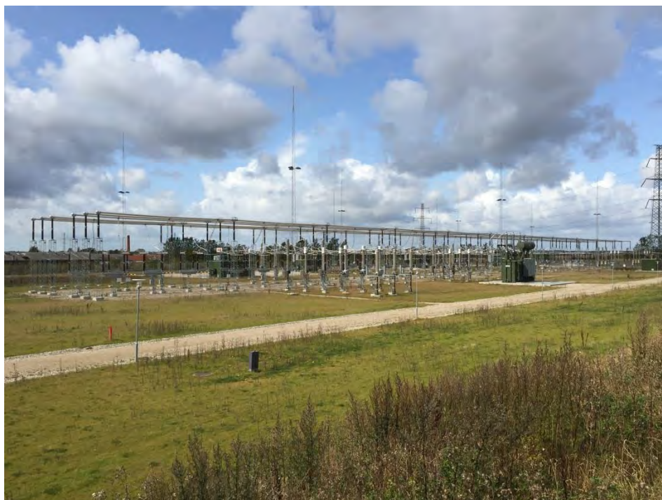
Figur 13 Eksempel på en 220 kV AIS station (Bjæverskov) – denne station indeholder fire kompenseringspoler, to linjefelter og et transformerfelt (selve transformeren står ved 400 kV stationen).
