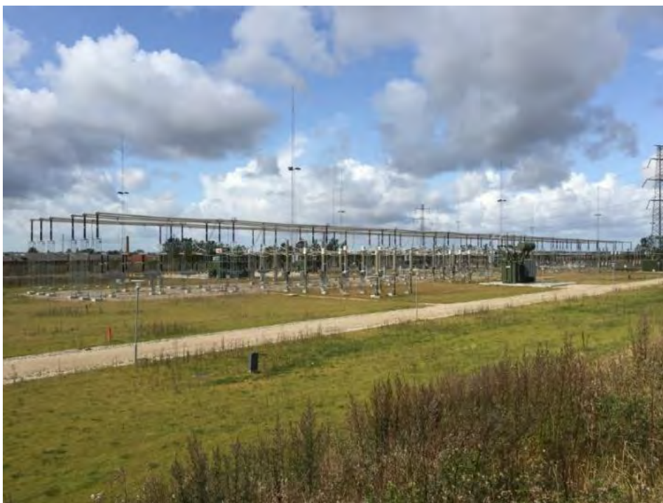
Figur 10 Eksempel på en åben 220 kV AIS-station.
