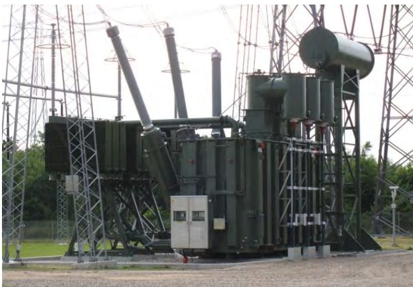
Figur 18 Eksempel på en 400/220 kV transformere (station Bjæverskov).
