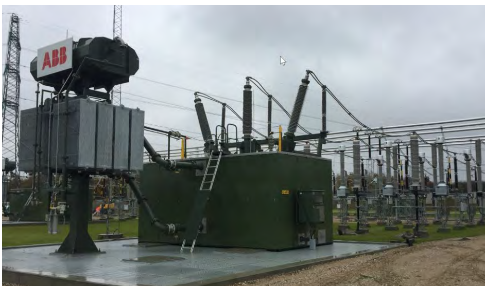
Figur 17 Viser en 220 kV kompenseringspole (station Bjæverskov).
