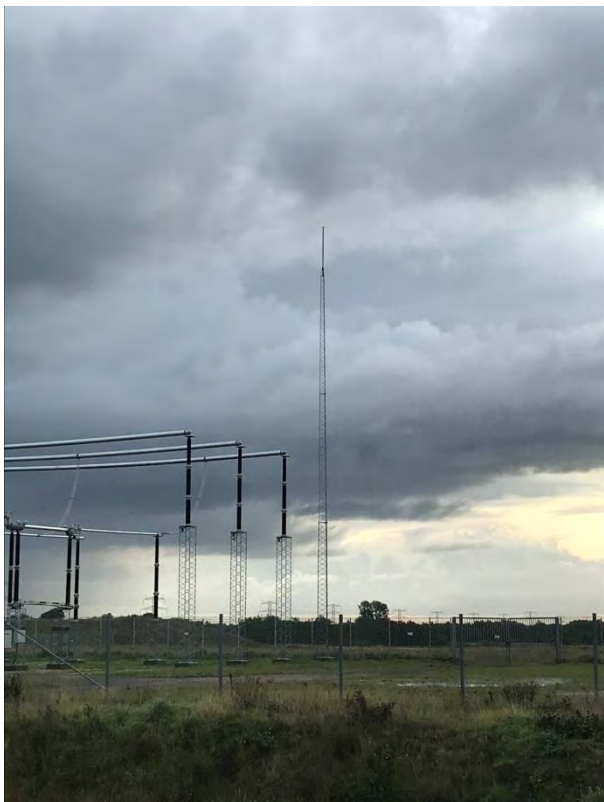
Figur 16 Eksempel på en lynfangsmast placeret for enden af en samleskinne
