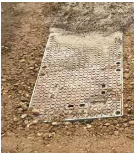
Figur 2-3 Eksempel på fiberbrønd i terræn
