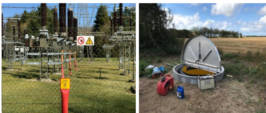
Figur 2-66 Eksempelfoto af markeringspæl og linkboksbrønd
