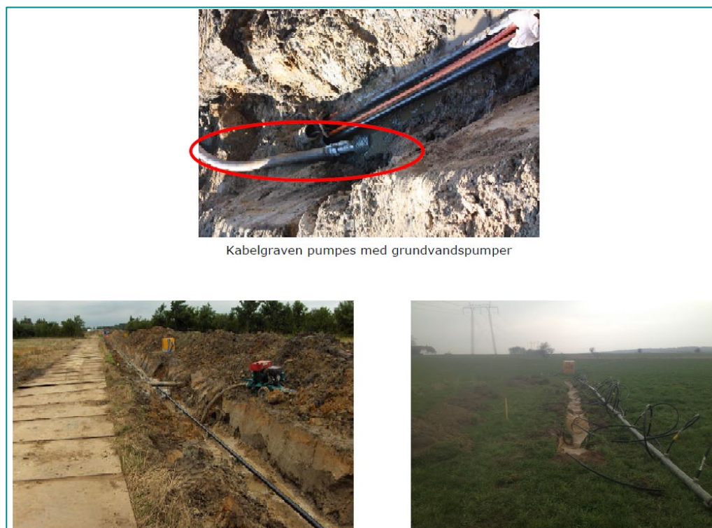
Figur 2-7 Forskellig metoder til at holde kabelgraven tør. På billedet til venstre etableres drænrør, til højre etableres sugespidsanlæg
