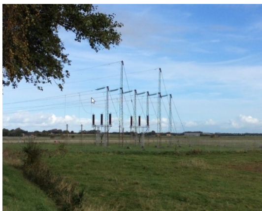
Figur 1.6. Eksempel på en overgangsmast.
