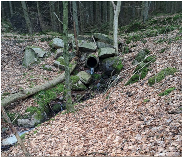
Figur 6: Overkørsel i målsat vandløb der udgør en totalspærring for vandrende fisk.
