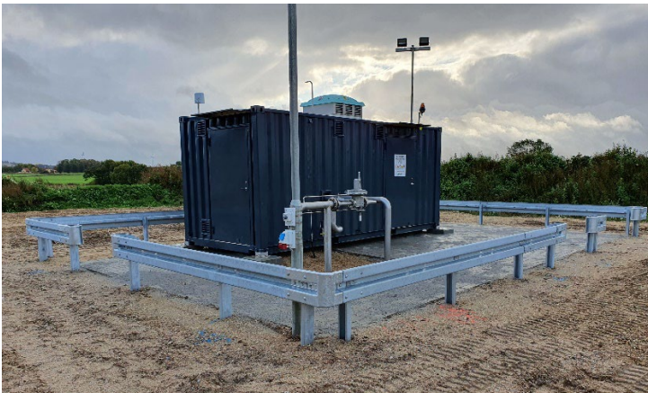
Figur 11 - Foto som viser eksempel på en BMR-station
