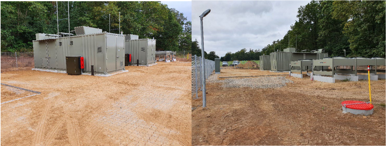
Figur 13- foto til venstre viser 2 kompressor-containerer med tilhørende el-skab (foran) og kølere (bagerst). Foto til højre viser køleanlæg (forrest) og 2 kompressor-containerer og el-skab til venstre (mod hegnet).
