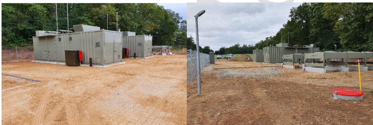
Figur 11. Foto til venstre viser 2 kompressor-containerer med tilhørende el-skab (foran) og kølere (bagerst). Foto til højre viser køleanlæg (forrest) og 2 kompressor-containerer og el-skab til venstre (mod hegnet). Kilde: Evida
