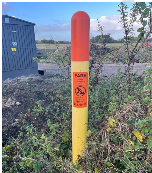
Figur 13 Markeringspæl for nedgravet gasledning. Pælene placeres typisk ved markskel og ved krydsning af veje og vandløb. Kilde: Evida
