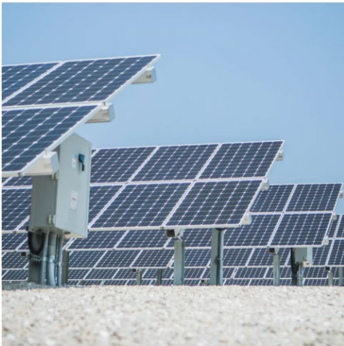
Figur 8: Eksempel på solceller med inverter monteret på stativ
