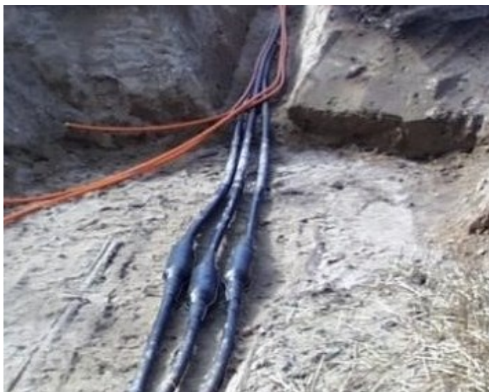
Figur 3.10 Kablerne er muffet sammen.
