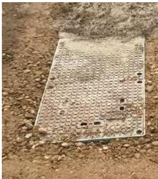
Figur 3.2 Eksempel på fiberbrønd i terræn
