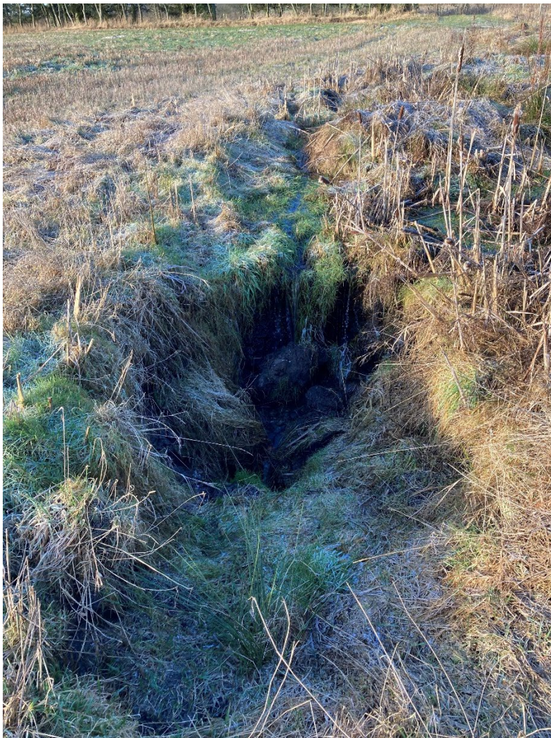
Figur 95. Jordfaldshul på sydsiden af grusvejen, hvor overfladevand fra vejen ledes tilbage i afløbsledningen.
