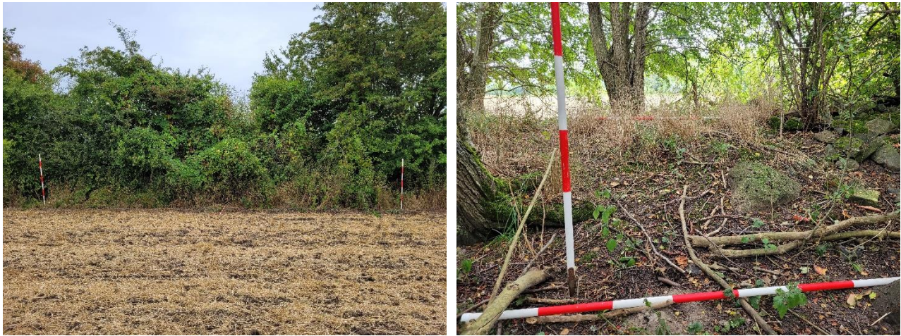
Figur 3 Fotos af det potentielle gennembrudssted. På fotoet til venstre ses diget med tilhørende hegn fra øst, og landmålerstængerne er placeret 10 m fra hinanden. Til højre ses et nærbillede af diget, hvor de vandrette landmålerstænger angiver toppen og foden af diget.
