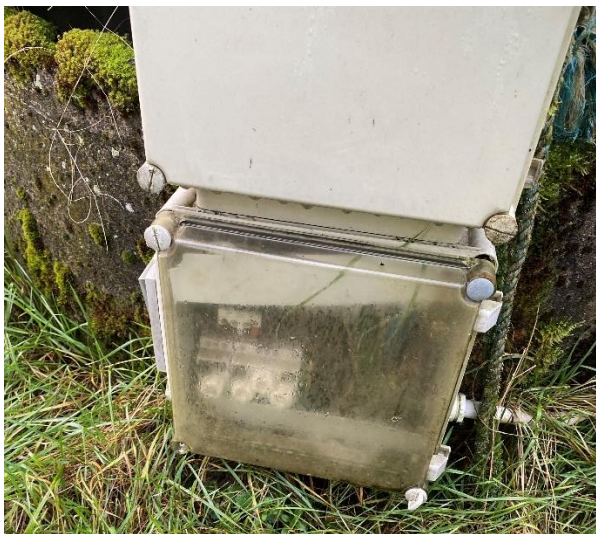
Figur 2.8 Eltavle tilknyttet pumpebrønd.
