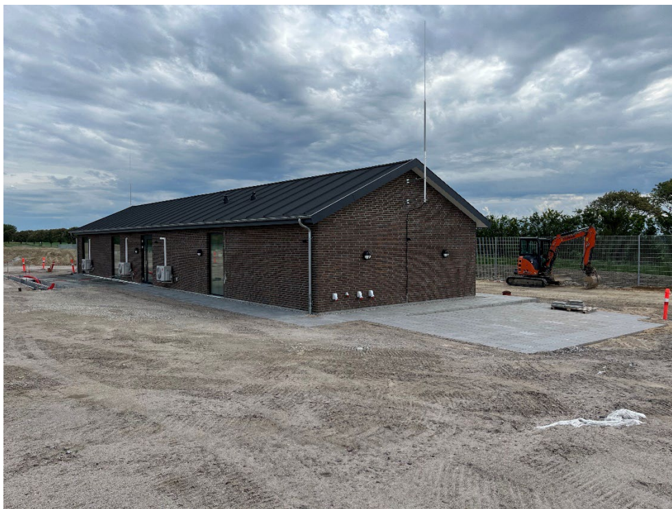
Figur 3-5 Eksempel på bygning på højspændingsstation. Kilde: Energinet.
