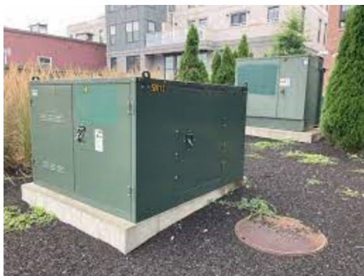
Figur 3-6 Eksempel på teknikkiosk.
