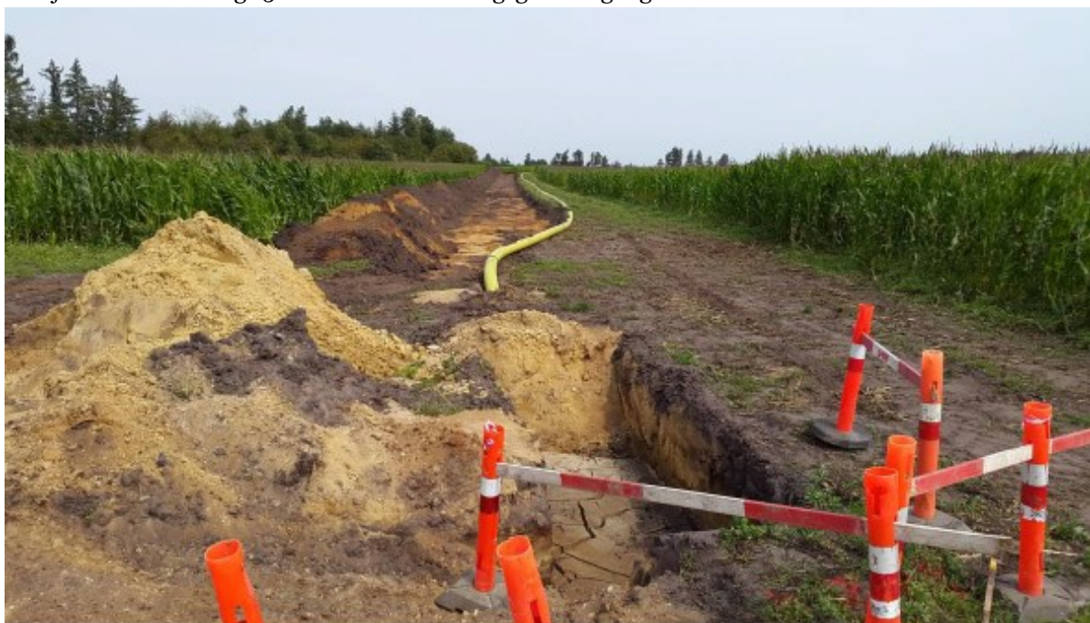
Figur 3: Eksempel på anlæggelse af gasledning i rørgrav. Gasrøret er svejset sammen og muldlaget er afrømmet og ligger klar ved kanten til den kommende rørgrav. Boregrube til underboring ses forrest i billedet. Kilde Evida.
