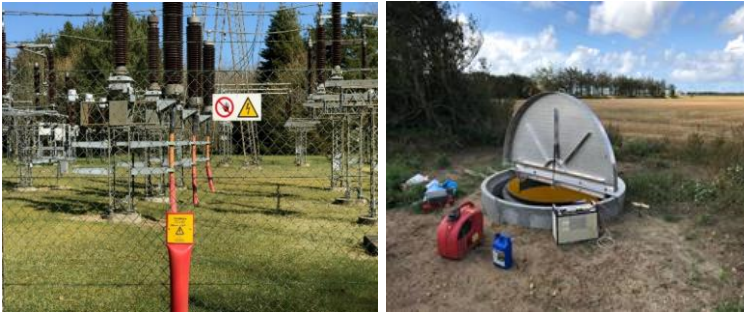
Figur 2-16 Eksempelfoto af markeringspæl og linkboksbrønd
