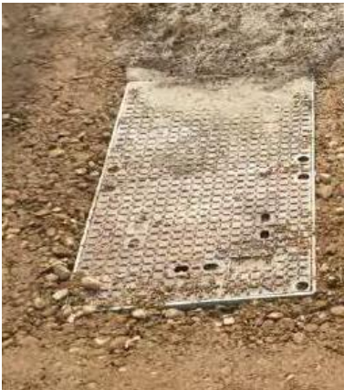
Figur 2-3 Eksempel på fiberbrønd i terræn
