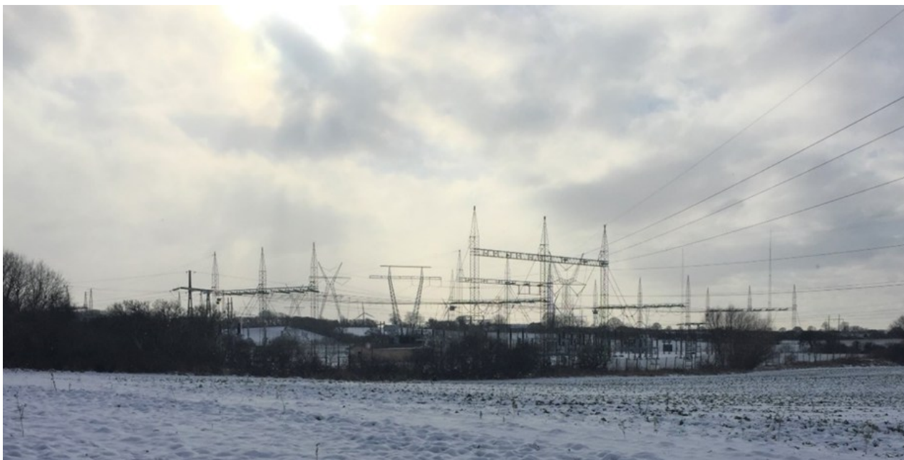
Figur 3.2 Eksempel på højspændingsstation.
